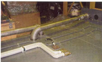
Bild 5: Füllrohre im ICE-TD
