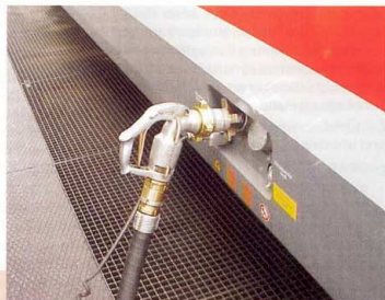
Bild 7: Zapfventil im Einfüllstutzen, nicht arretiert
